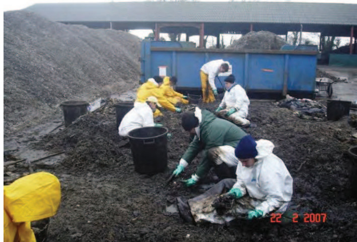
Tri de déchets avant le prétraitement (nécessaire en cas d'absence de tri durant la collecte) (Source : Le Floch Depollution)
